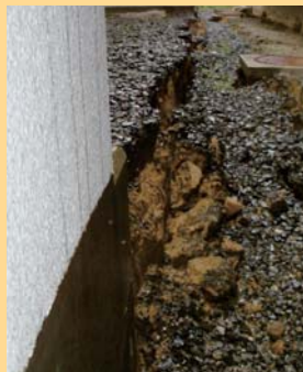
病院建物周囲の地盤の亀裂
